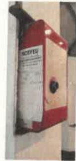
Commande de désenfumage
