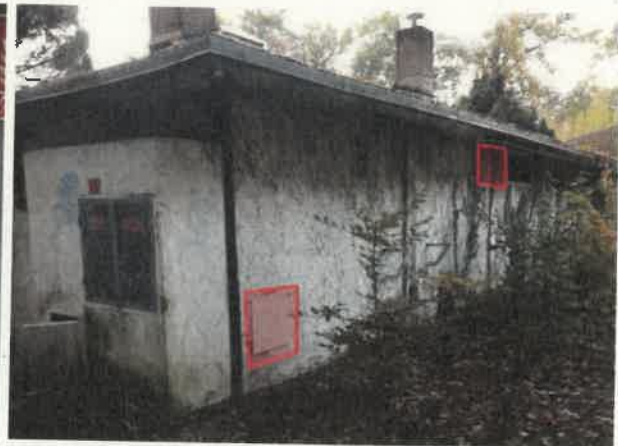
Emplacements des ventilations basse haute du local chaufferie
