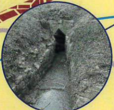
Sortie galerie d'évacuation des eaux de l'étang (Traoucats)
